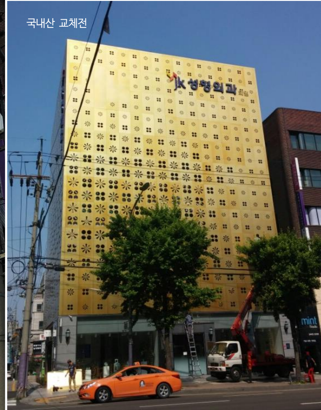
↑ 국내산 아노다이징 시공 사진, 이색발생 후 전량교체
